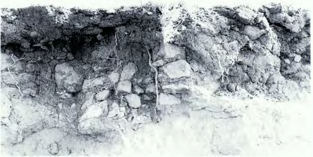
Εικ. 8. Τοίχοι σπιτιών μετά την καταστροφή.
