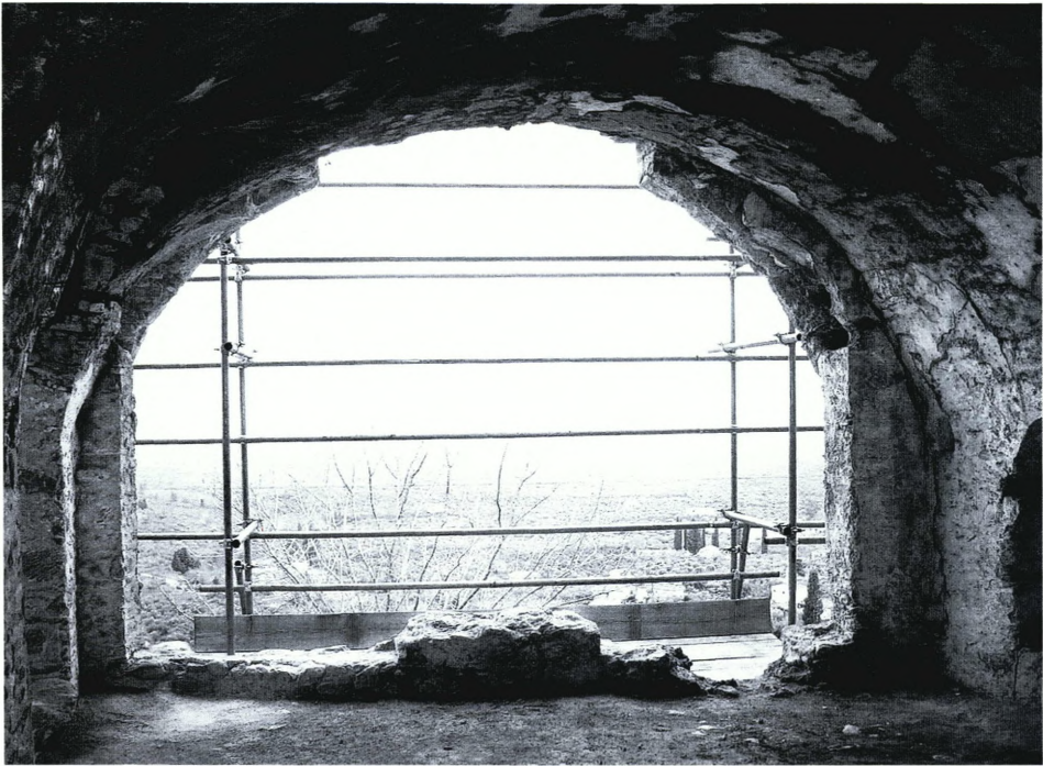
Εικ. 15. Βόρειος χώρος της β' στάθμης. Εσωτερική άποψη προς Α. μετά την καθαίρεση του διαφράγματος του τόξου της περιόδου της Τουρκοκρατίας.
