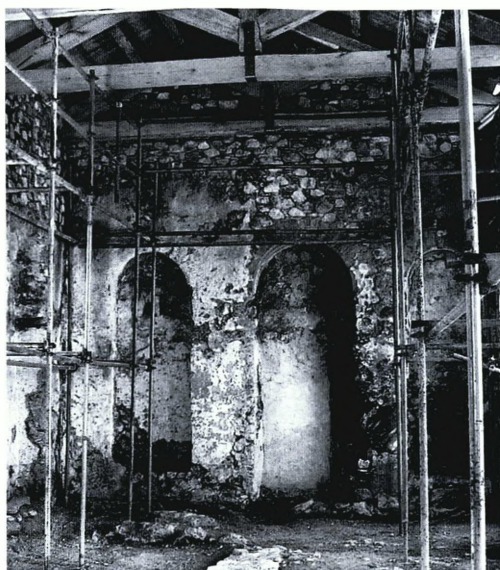
Εικ. 12. Τρίκλινο. Αποψη προς Δ., μετά την αποκατάσταση της τρίκογχης διαμόρφωσης. Αποκάλυψη τμήματος τόξου προγενέστερης δόμησης.
