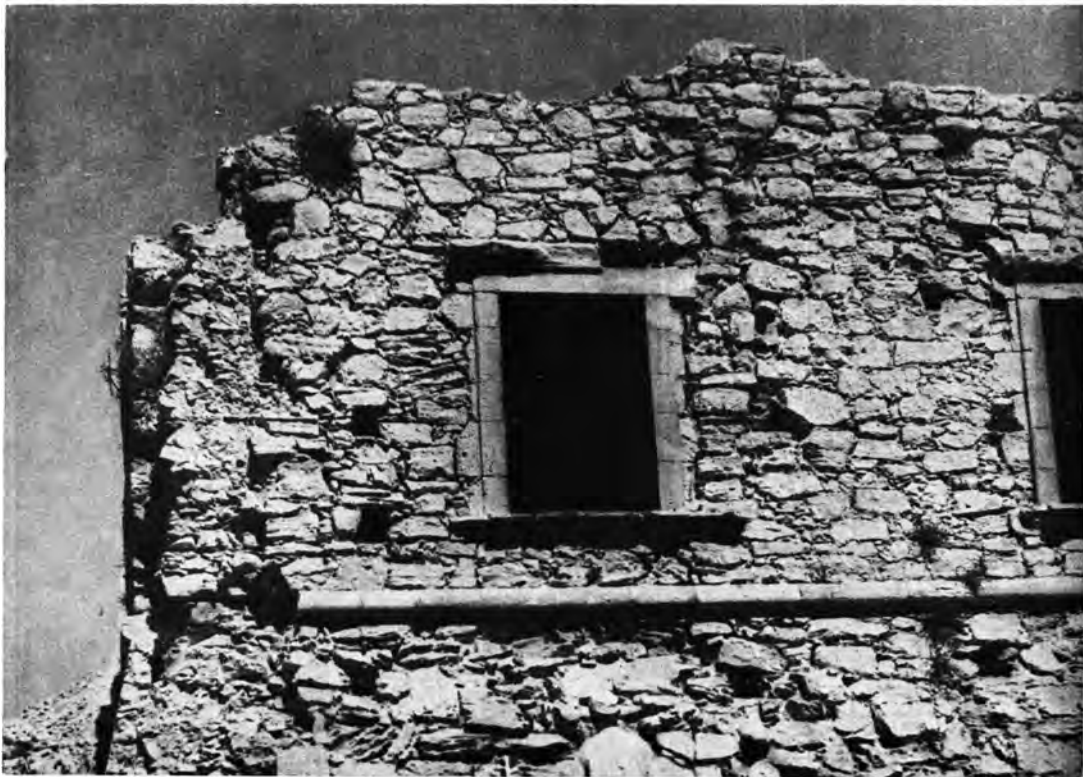
Κρήτη. Ἐτιά Σητείας: α - β. Ἀνατολική ὄψις καὶ νοτιοανατολική γωνία ἐπαύλεως τῶν Mezzo πρὸ τῶν ἀναστηλωτικῶν ἐργασιῶν
