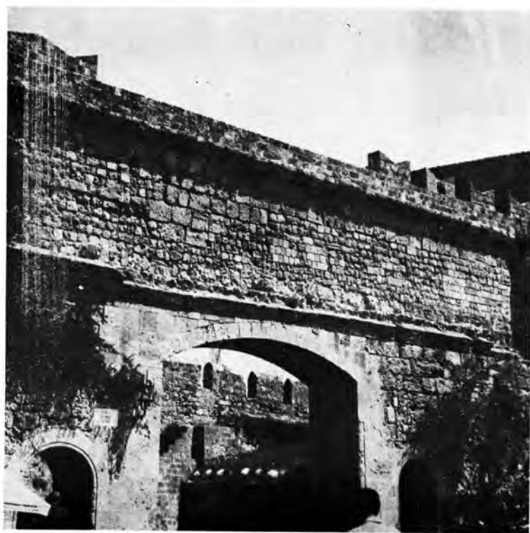
Ρόδος: α - β. Νεωτέρα “Πύλη τῆς Ἐλευθερίας” (νοτία ὄψεις) πρὸ καὶ μετὰ τὸ πέρας τῶν ἐργασιῶν στερεώσεως τῆς ἐπιφανείας τοῦ ὑπερκειμένου τοίχου
