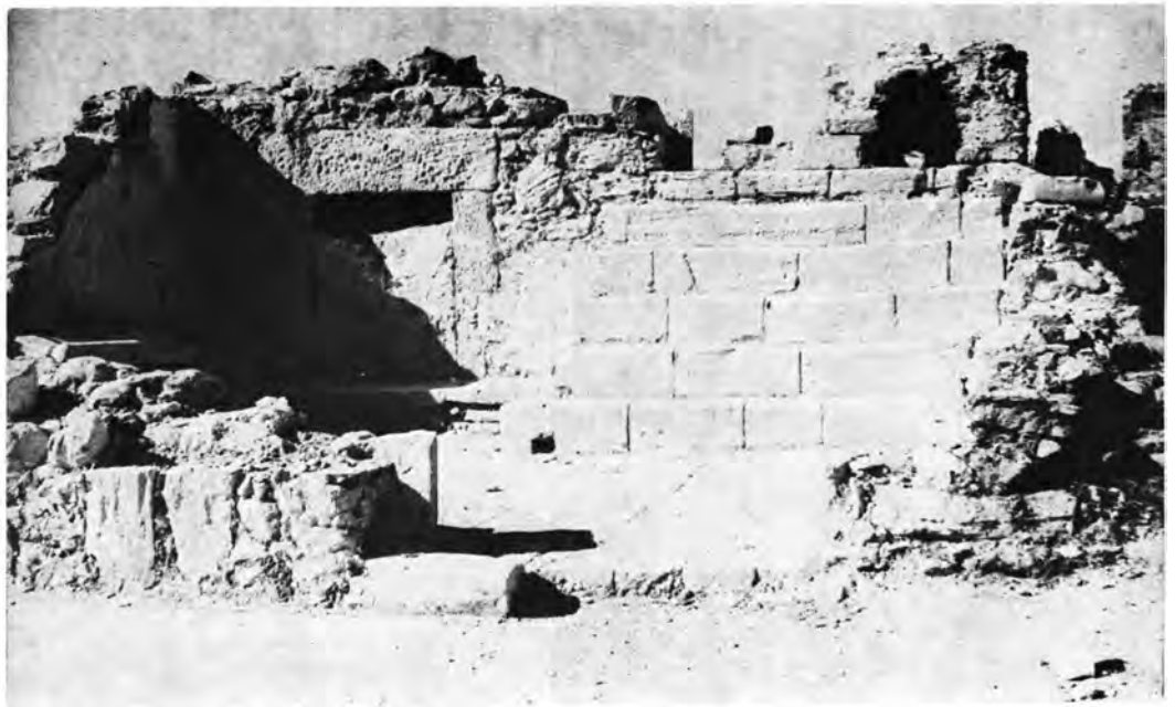
Κρήτη. Ἐτιὰ Σητείας. Ἐπαυλις τῶν Mezzo: α. Τμήμα τῆς ἀνατολικῆς ὄψεως μετὰ τὰς ἀναστηλωτικὰς ἐργασίας, β. Ἐν τῶν διαμερισμάτων τοῦ ὀρόφου μετὰ τὸν καθαρισμὸν
