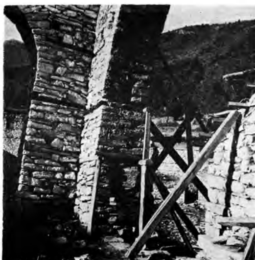
Ἰ. Μονὴ Εἰκοσιφοινίσσης Παγγαίου: α. Λεπτομέρεια τῆς στέγης πρὸ τῆς ἐπισκευῆς, β. Στέγη τοῦ ναοῦ πρὸ τῶν ἐπισκευῶν, γ. Ὁ ἀναλημματικὸς τοῖχος μετὰ τὴν ἐπισκευήν, δ. Ἡ στέγη μετὰ τὴν ἐπισκευήν, ε. Ἔργασια ὑποστηλώσεως κατὰ τὰς ἐργασίας συντηρήσεως
