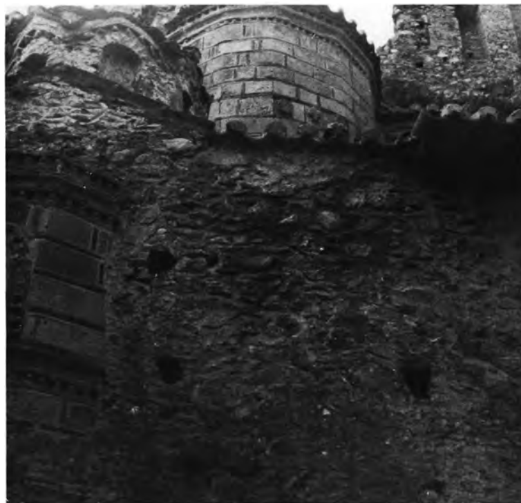
Μυστράς. Περιβλεπτος : α. Λεπτομέρεια τῆς Ν. πλευρᾶς μετὰ τὰς ἐργασίας, β. Ἡ Α. πλευρὰ μετὰ τὰς ἐργασίας
